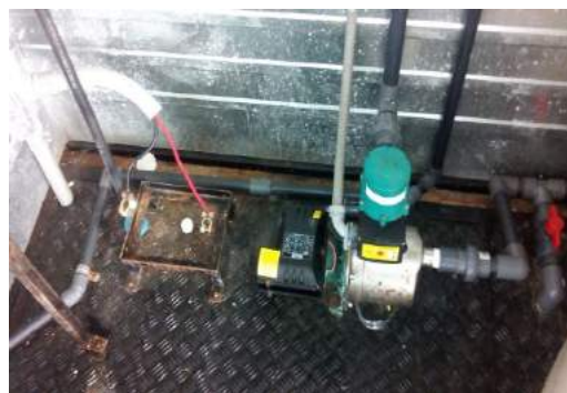
Figura 3. Corrosión en la estructura de la base del equipo de transporte de la PPAITSM
