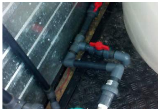
Figura 2. Corrosión en la estructura de la PPAITSM
