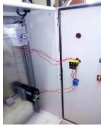
Figura 17. Gabinete con elementos eléctricos
