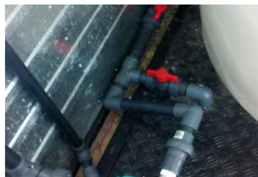
Figura 2. Corrosión en la estructura de la PPAITSM
