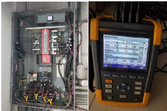
Figura 2. Conexión del analizador de redes al gabinete principal
