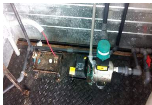
Figura 3. Corrosión en la estructura de la base del equipo de transporte de la PPAITSM
