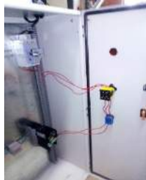
Figura 17. Gabinete con elementos eléctricos
