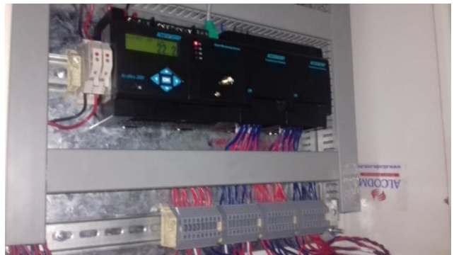
Figura 7. Medidor AcuRev2020 Instalado
