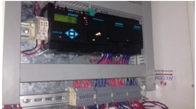
Figura 7. Medidor AcuRev2020 Instalado
