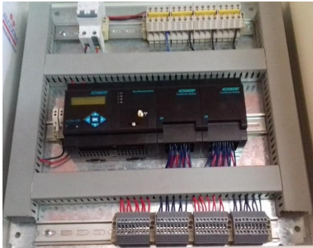
Figura 5. Vista del Medidor Terminado de Cablear.
