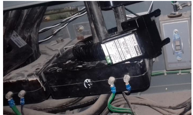
Figura 8. Vista de Transformador Bipartido Montado en Línea Principal
