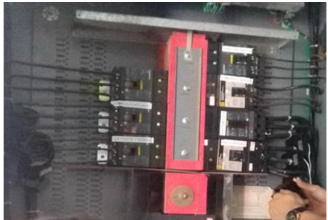
Figura 9. Centro de carga principal con transformadores de corriente bipartidos instalados
