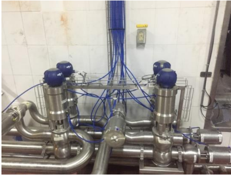
Figura 19: Válvulas Mixproof en el SKID
