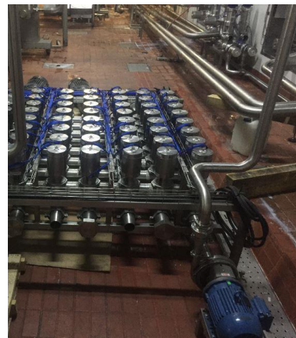
Figura 18: Clúster nuevo instalado
