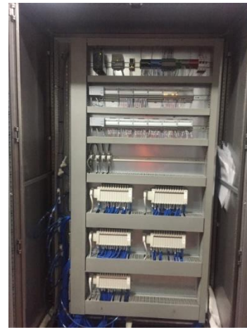
Figura 17: Gabinete de control nuevo
