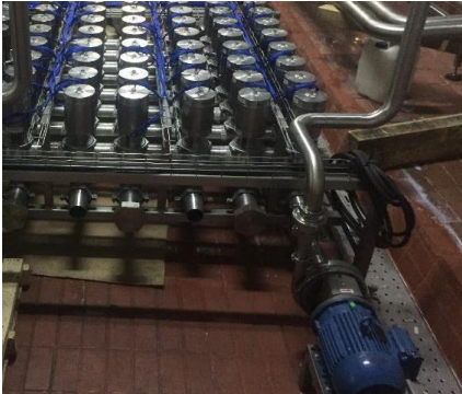
Figura 6: Clúster nuevo instalado
