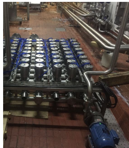
Figura 18: Clúster nuevo instalado
