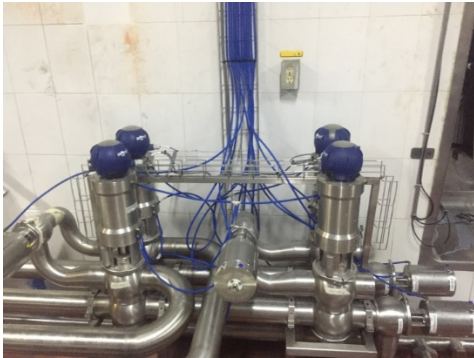
Figura 19: Válvulas Mixproof en el SKID
