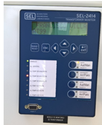
Figura 4. Monitor de transformador utilizado.
