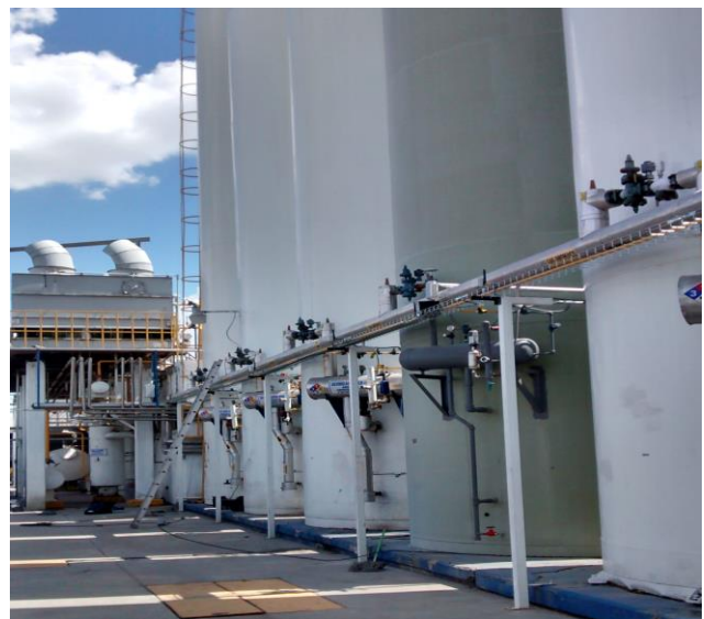
Figura 5. Silos con adaptadores y sensores instalados.
