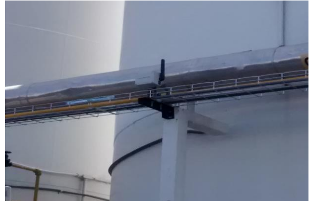
Figura 3. Ubicación del adaptador WirelessHART en uno de los silos de almacenamiento
