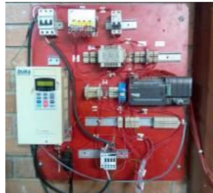
Figura 8. Tablero de control.
