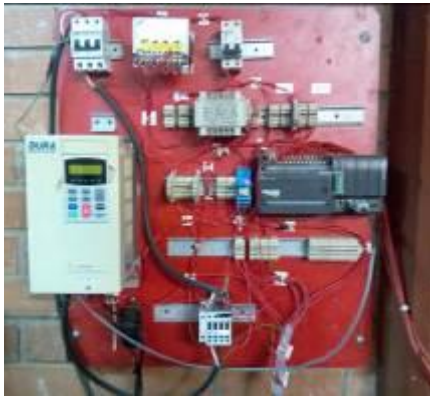
Figura 8. Tablero de control.
