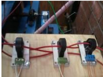
Figura 14. Sensores de corriente instalados.
