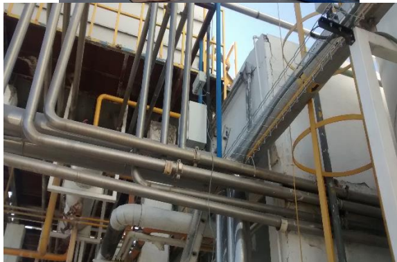
Fig 5. Silos con adaptadores y sensores instalados.
