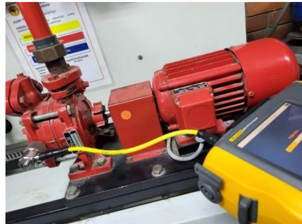
Figura 19. Medición de vibraciones del motor acoplado a bomba en ITSL
